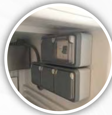
Prises électriques internes
